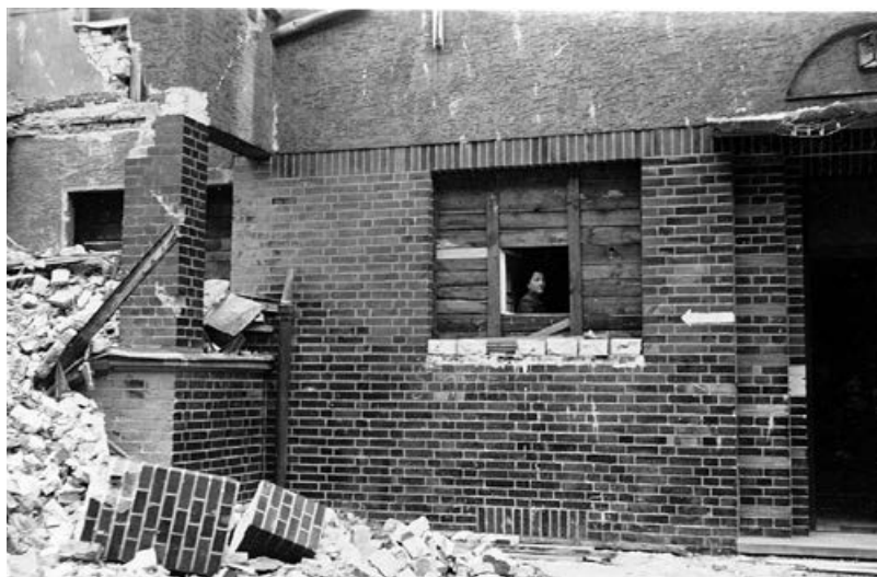
Provisorische Abdichtung eines Fensters in der frühen Nachkriegszeit
